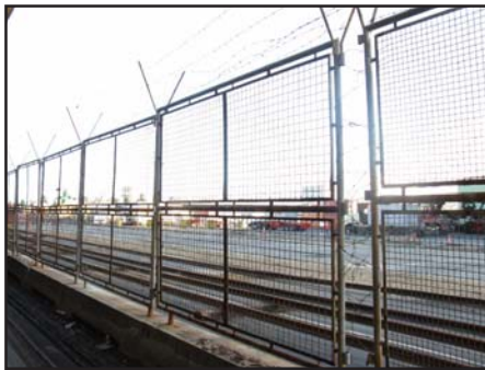
Cloture conforme aux normes ISPS et entourant une zone d'installation portuaire
