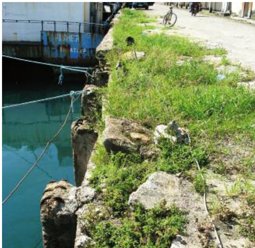
Etat actuel de dégradation des quais des darses
