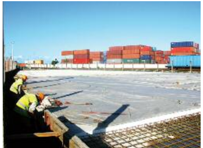
La couche de fondation en tout venant 0/100 du nouveau site de stockage de chromite
