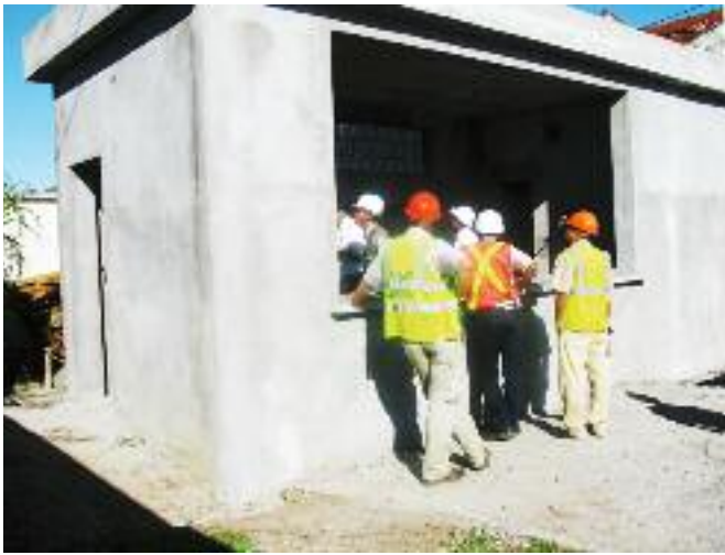
Construction du bureau de la Brigade ZP au niveau de l'entrée du port (Portail n°5)
