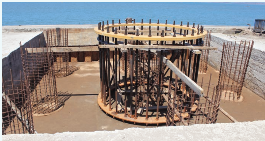
Début de la construction pour l'installation d'une grue à conteneur au port de Mahajanga
